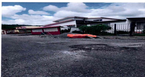
Figura 2. Escombros en vía pública y con pésima rotulación a 75 metros de la Escuela.
