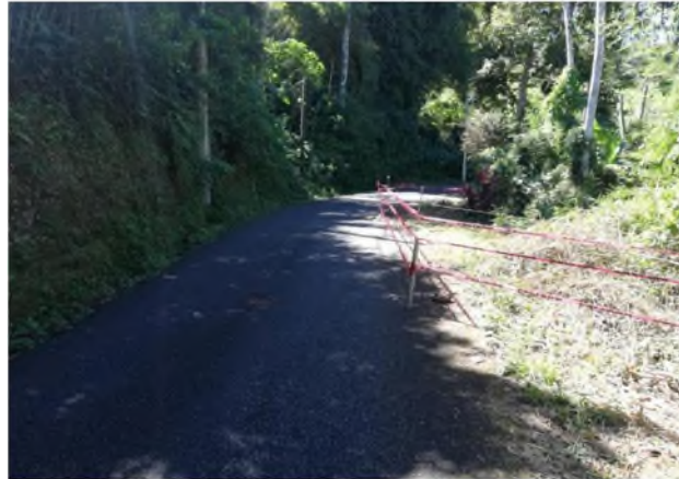
Perímetro del camino con cinta de precaución, requiere señalización vertical
