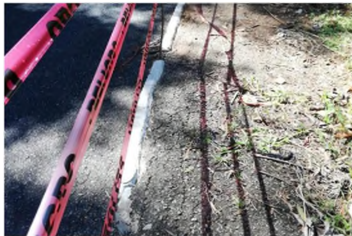
Fisuras en el asfalto
