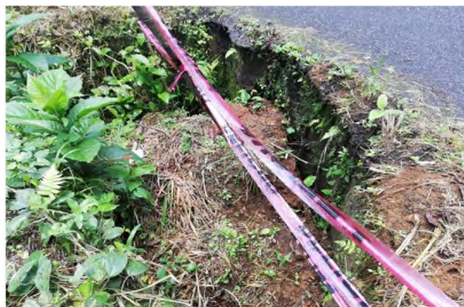
Tubos de alcantarilla desplazados
